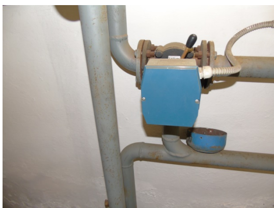
Figura 4.7 - Particolare della valvola miscelatrice
