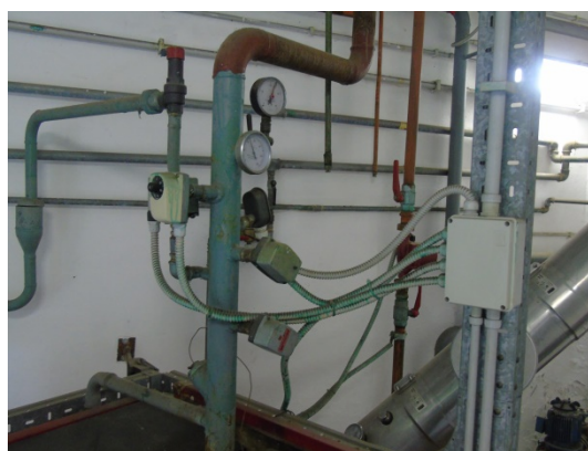
Figura 4.8 – Sonda di temperatura sulla tubazione di mandata
