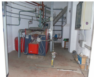
Figura 8.5 – Sistema di generazione obsoleto da sostituire
