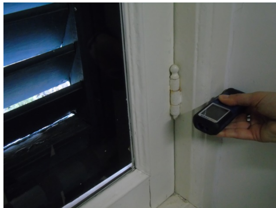
Figura 8.3 - Particolare serramenti da sostituire.
