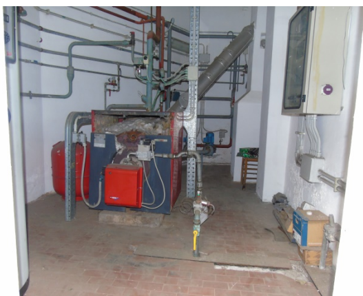
Figura 4.11 - Generatore di calore – RIELLO 4RCT6
