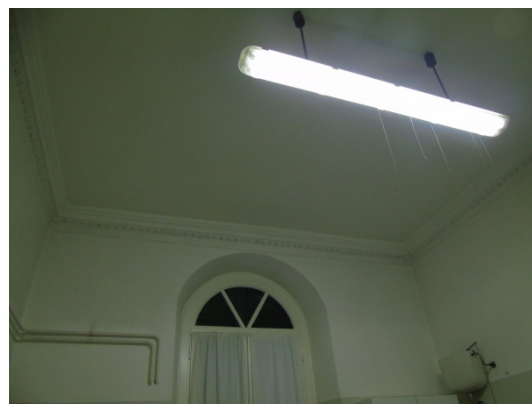
Figura 4.14 - Particolare dei corpi illuminanti ubicati nelle aule
